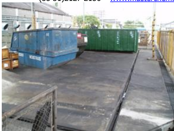
➡ As caçambas permitem infiltração de óleo no solo.
